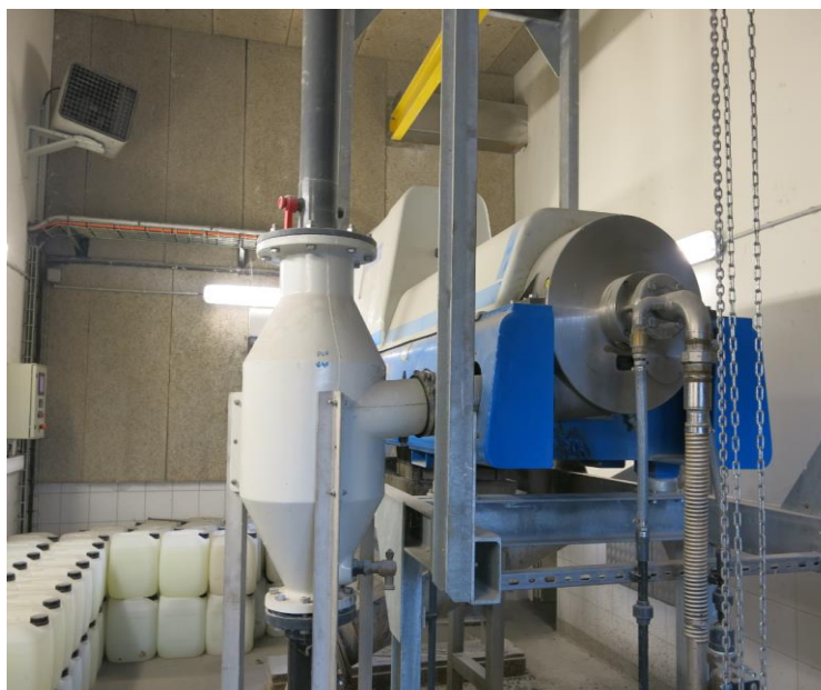
Figura 86 : Tratarea mecanică a nămolului bazat pe Centrifugă
