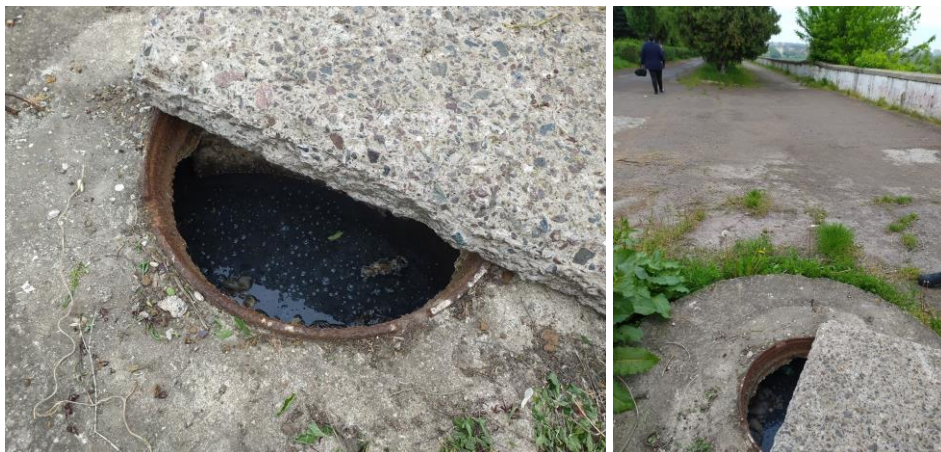
Figura 30: Gura de canalizare complet umplută de ape uzate lângă râu
