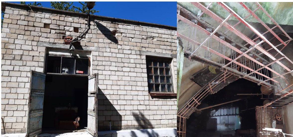
Figura 20: Stația de pompare Sud
