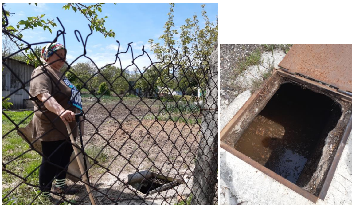
Figura 45: Groapă de înmuiere unde se scurge apa gri de la o casă individuală (stânga) și rezervor de reținere de apă dintr-un amplasament industrial (dreapta)
