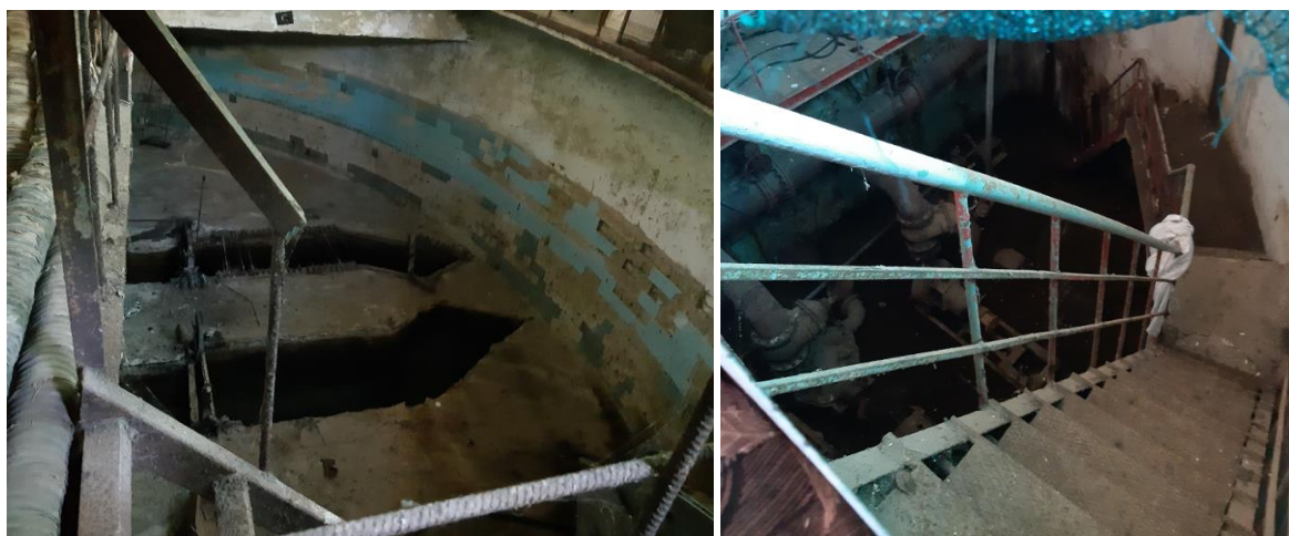
Figura 19 : Stația de pompare Centru
